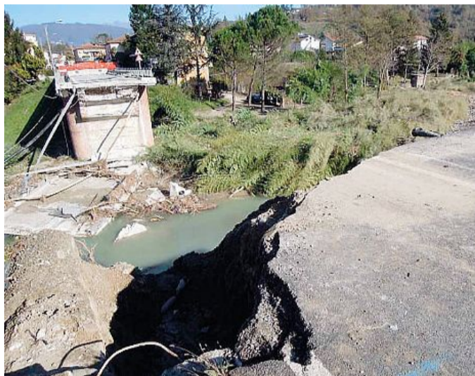
Il ponte crollato di Serricciolo (foto Cuffaro)
